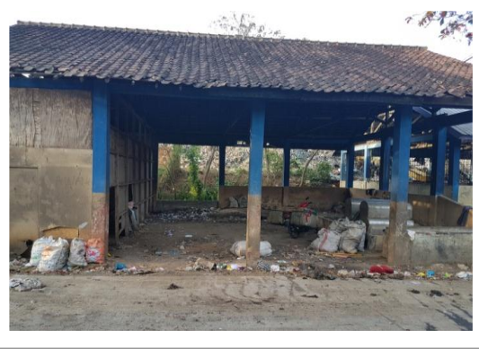
Lokasi pengomposan sampah
